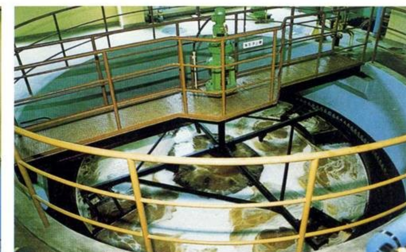
▲加圧浮上処理設備
