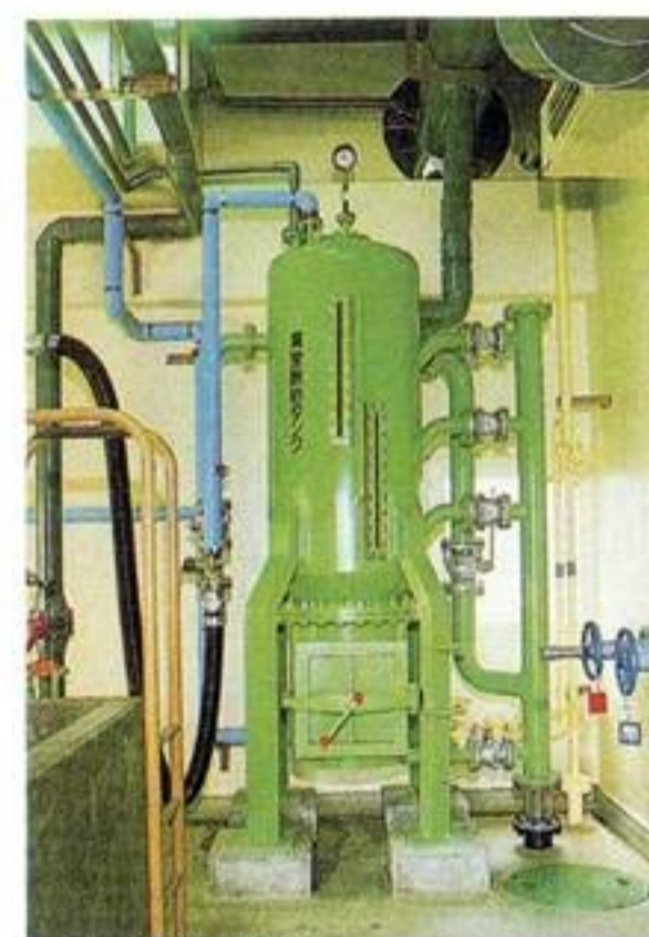
▲沈砂除去装置
