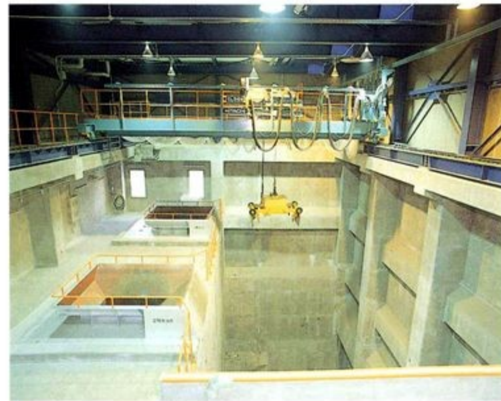
2 ごみピット・ごみクレーン ごみピットにためられたごみを、ごみクレーンでつかみ、ホッパへ投入します。
