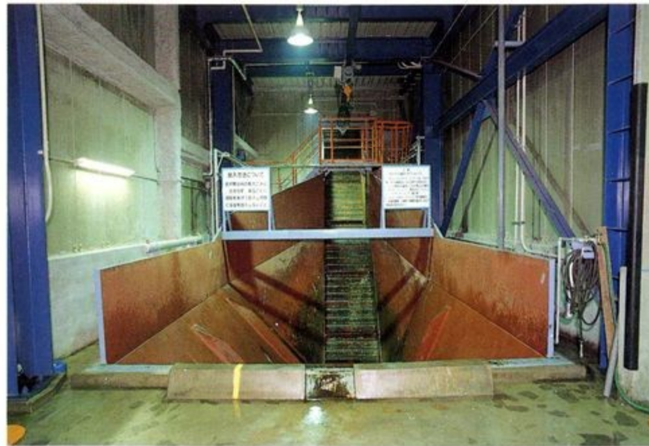
受入ホッパ 収集された粗大ごみ・不燃ごみは、受入ホッパに投入されます。
