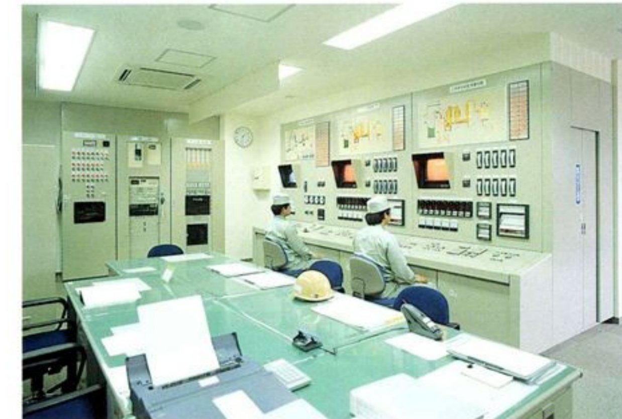
●中央操作管理室 工場全体の頭脳にあたる「中央操作管理室」には、すべての機器の運転状況を示す計器類が集められ、集中監視と遠隔操作での確かな運転を行います。
