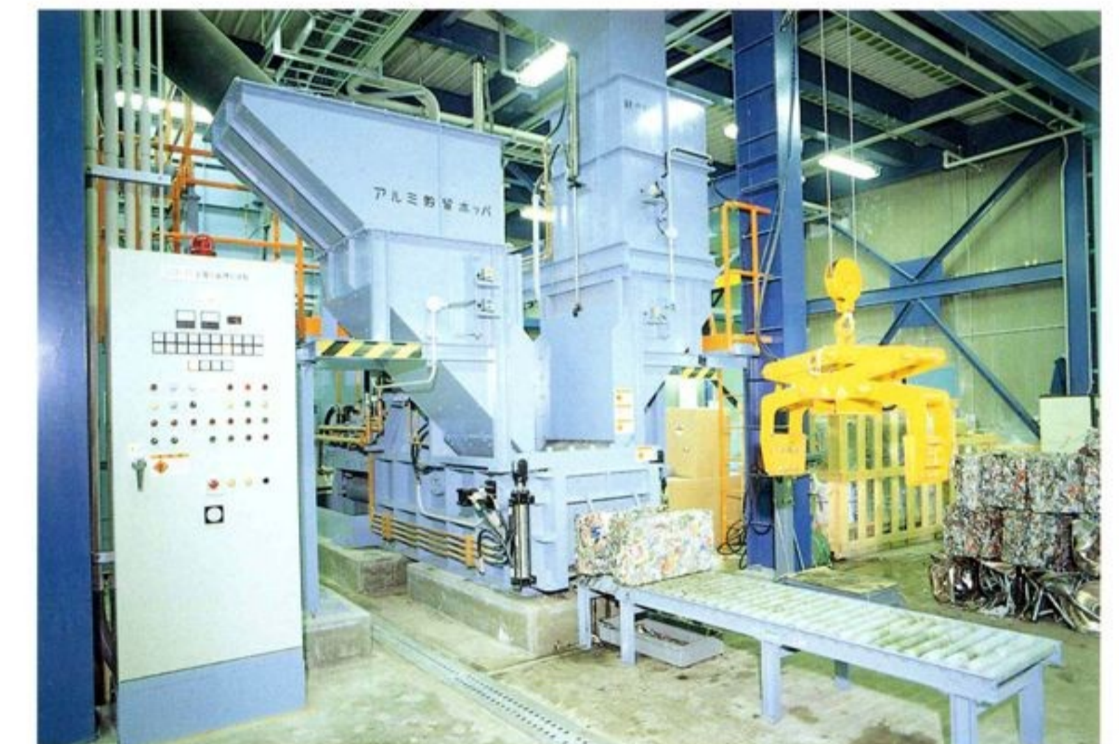
金属圧縮機 回収された鉄分とアルミは、金属圧縮機で圧縮成形された後、搬出用ホストで車に積み込まれます。
