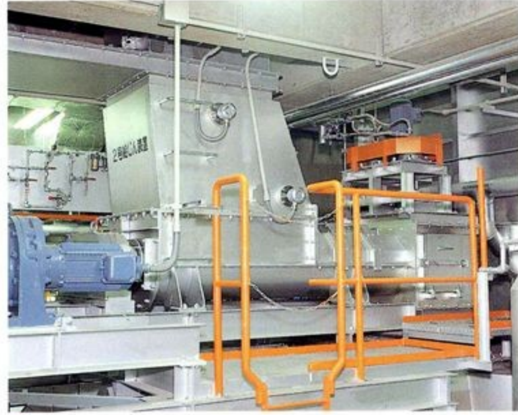
4 給じん装置 二軸のスクリューによって、ごみを安定かつ連続的に焼却炉へ送ります。
