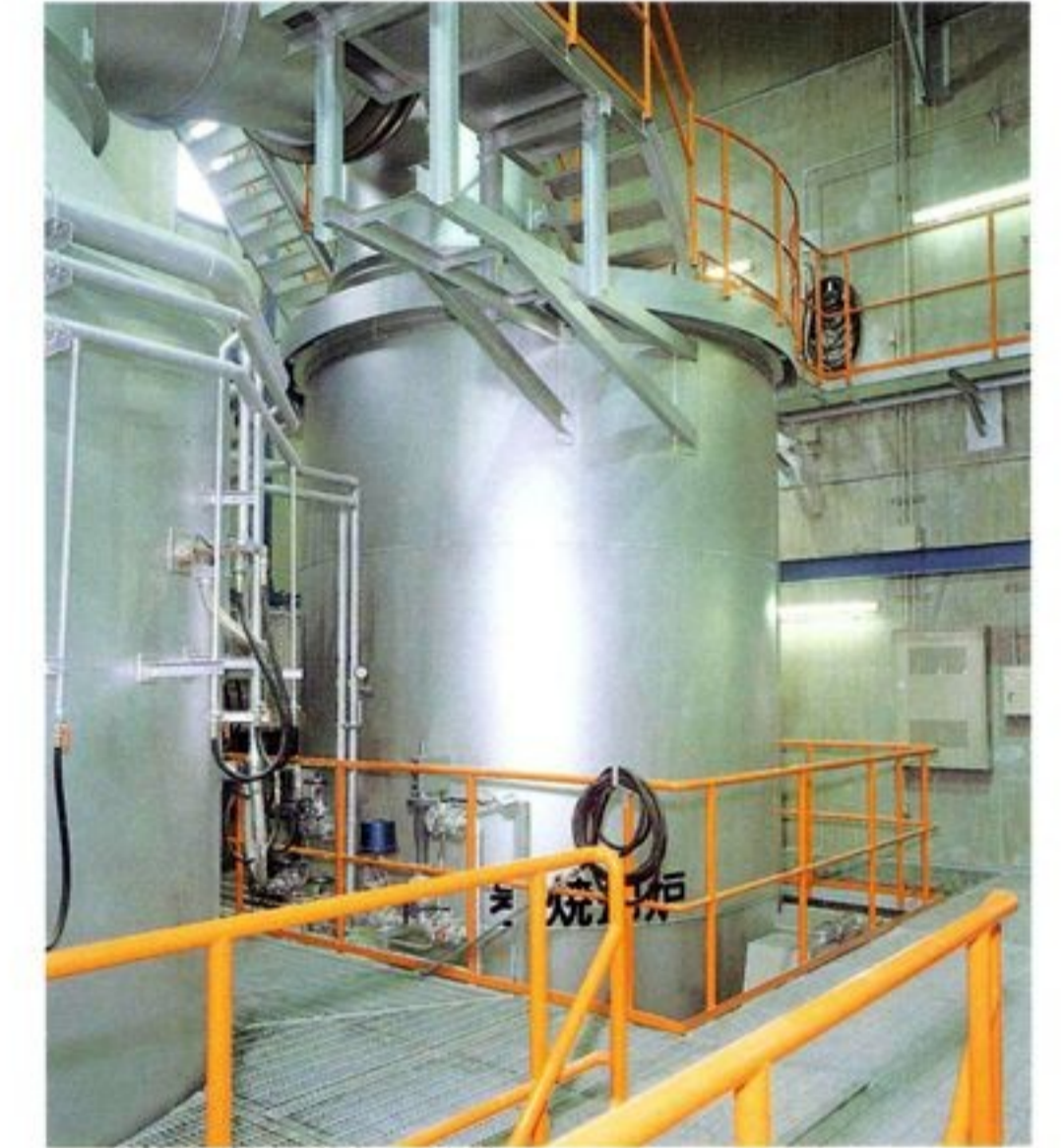
7 焼却炉 自動燃焼制御装置によって、つねに最適な状態でごみを完全焼却します。
