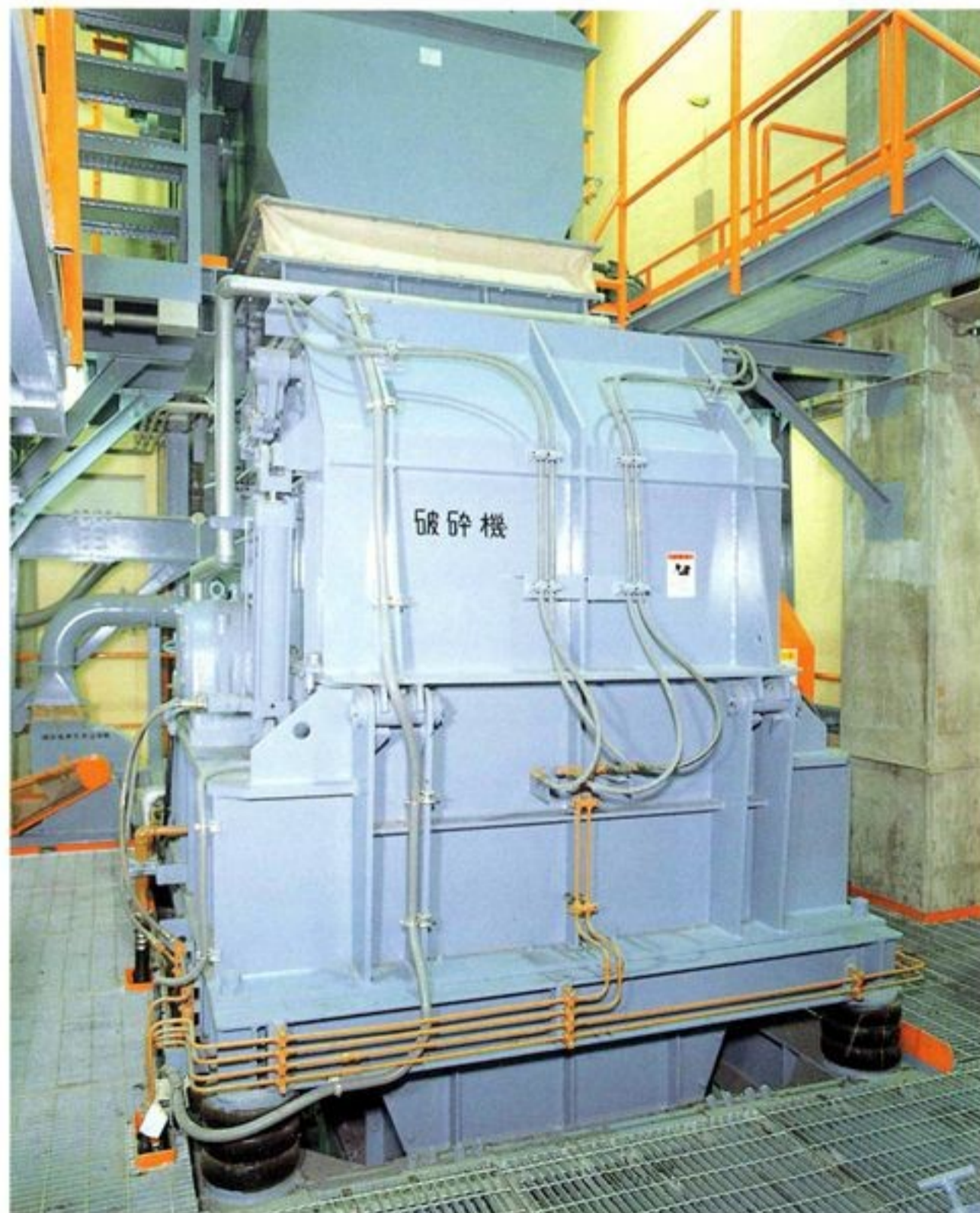
破砕機(回転式破砕機) 高速で回転するハンマによって、粗大ごみを破砕します。
