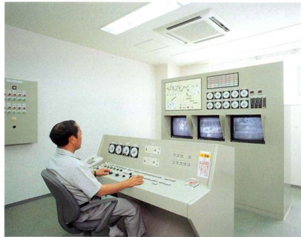
操作室 粗大ごみ処理施設全体の機器の運転と監視を行います。
