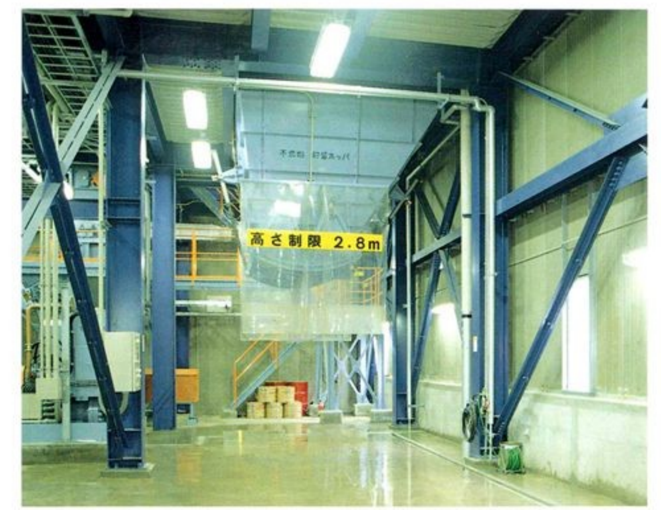
不燃物貯留ホッパ 選別された不燃物を、搬出するまでの間いったん貯留します。
