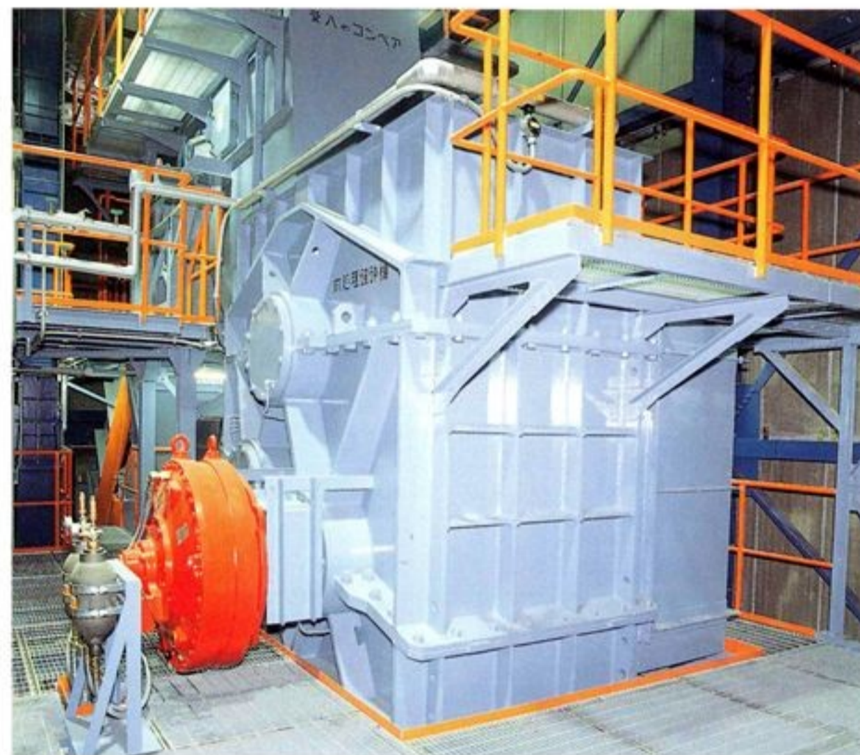
前処理破砕機 三軸回転破砕機で、粗大ごみを前処理破砕します。
