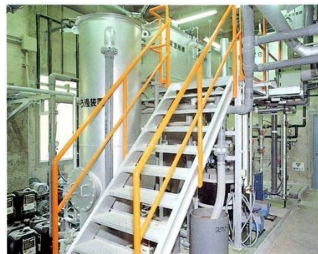
3 排水処理設備 発生した排水は、凝集沈殿ろ過の処理をしてセンター内で再利用し、場外には排出しません。
