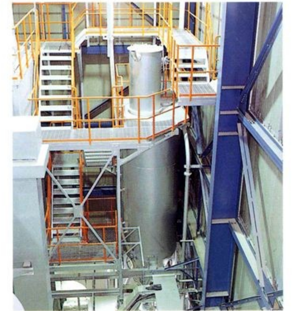
有害ガス除去装置 排ガスに含まれている有害ガスを、消石灰の噴霧によって効率よく反応させ、除去します。
