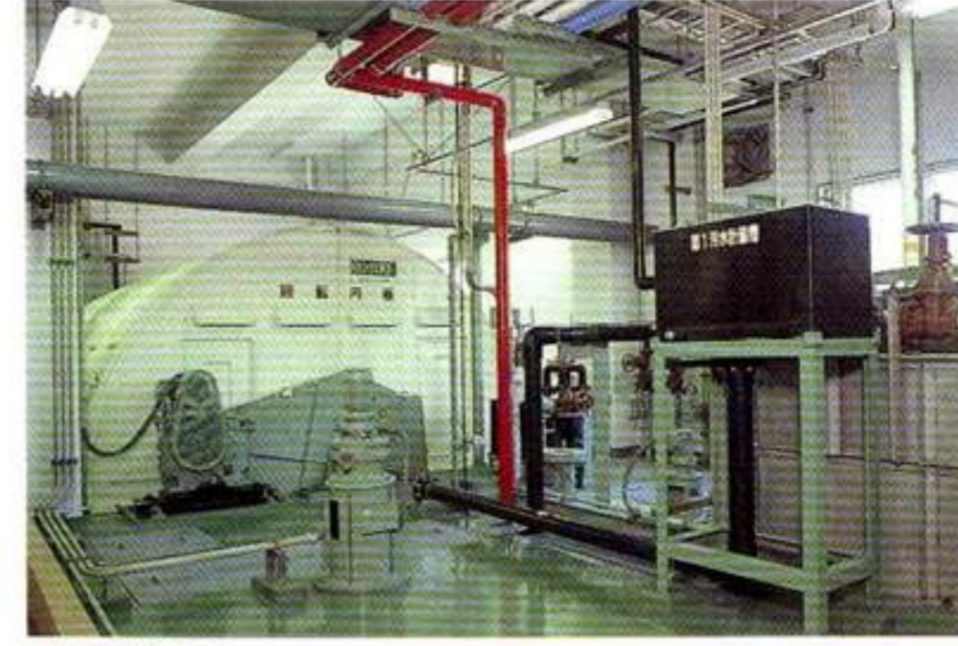
回転円板設備
