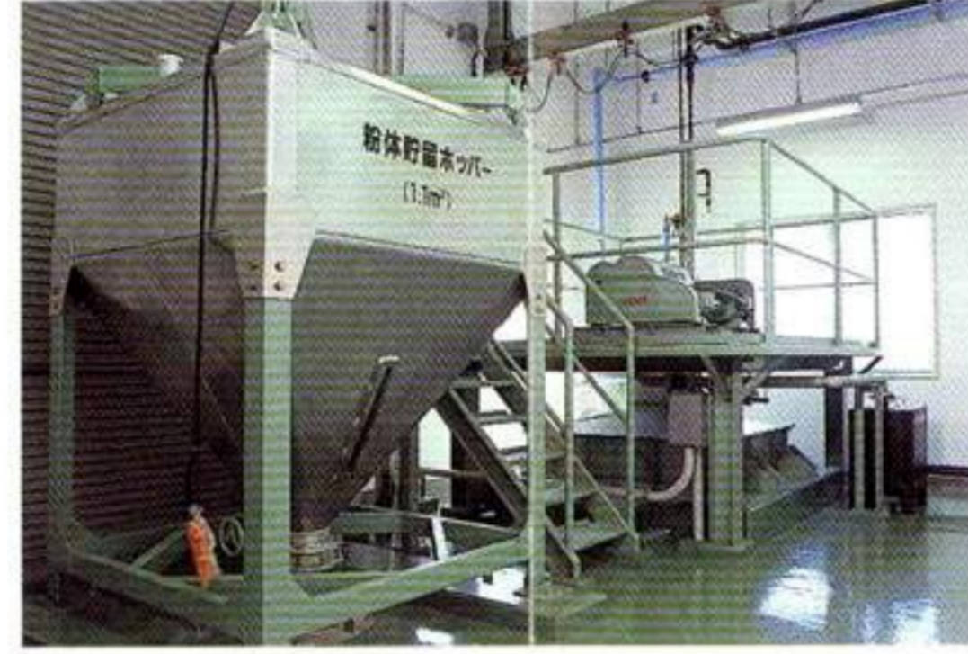
脱水機・ホッパー設備
