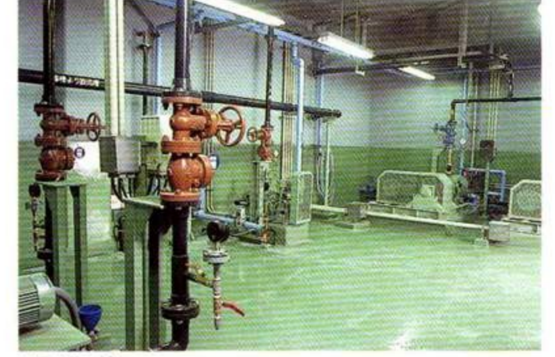
地下ポンプ室
